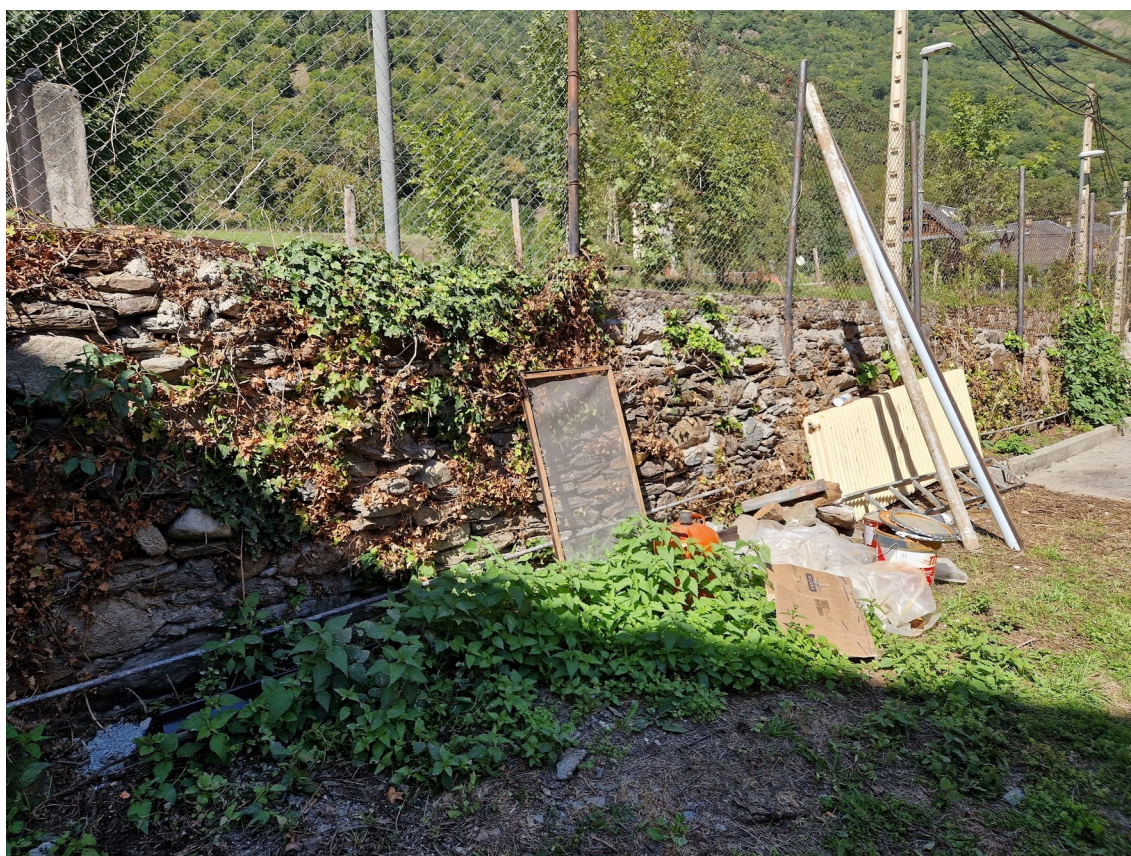
Imatge 2. S'aprecia el mal estat del mur.
