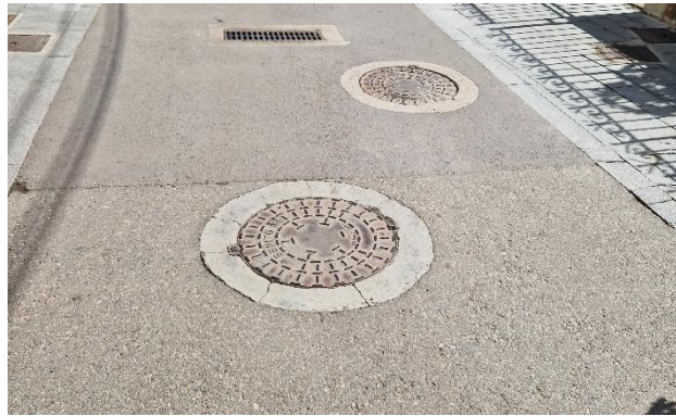
Imatge 03. Tapes de pous de clavegueram on substituir la goma
